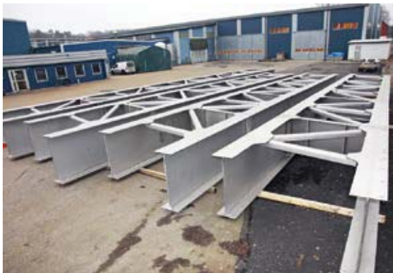
Färdiga brosektioner på Stål & Rörmontage gård i väntan på transport upp till Stockholm.
