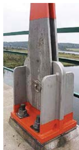
Bild 1. Måla 130 mm av de material som står i kontakt med varandra, t.ex. det kolstålet och det rostfria materialet för att undvika att galvanisk korrosion uppstår.
